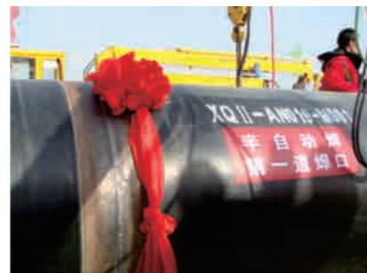
天然气管线 Gas pipe line
