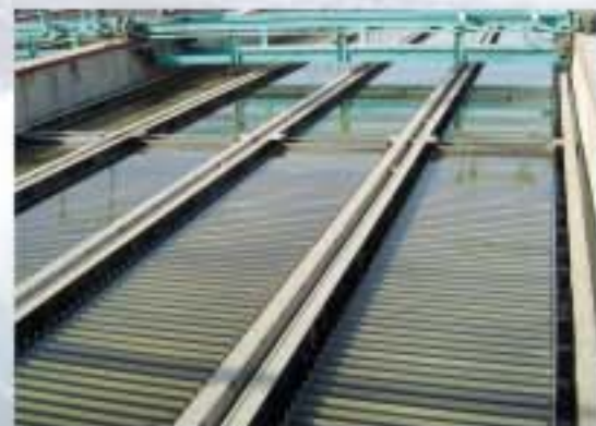
水槽 Water channel
