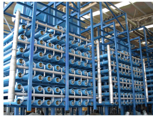
污水处理 Sewage treatment
